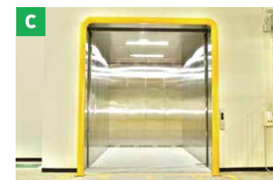
貨物用エレベーター
